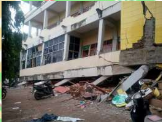
Gambar 1.1 Kerusakan Gedung akibat gempa
