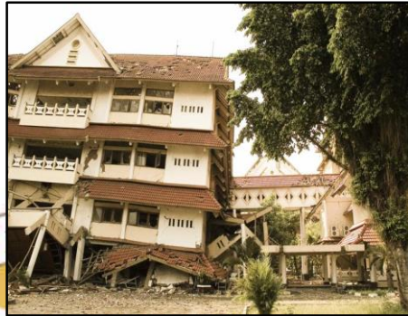
Gambar 1.1 Kerusakan Gedung akibat gempa
