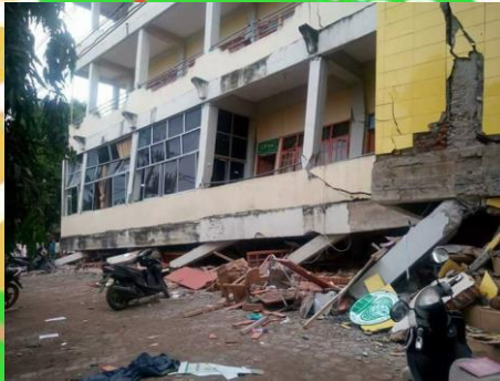
Gambar 1.1 Kerusakan Bangunan akibat gempa
