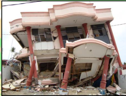
Gambar 1.1 Kerusakan Gedung akibat gempa
