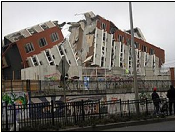
(a) Keruntuhan gedung, Chile
