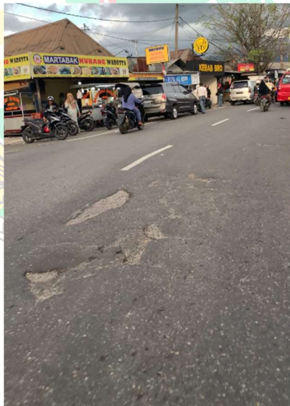
Gambar 1. 2 Kondisi Ruas Jalan Raya Bandar Buat
