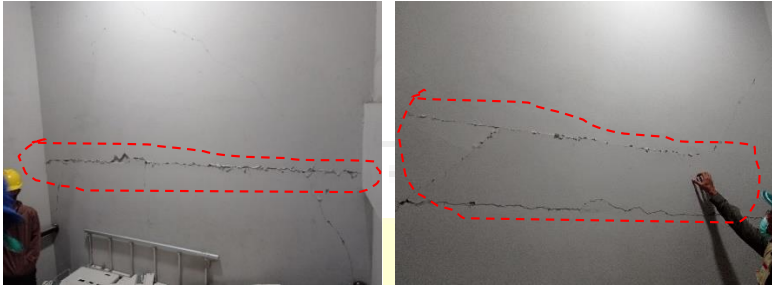
Gambar 1.3 Kerusakan Bagian Dalam Gedung
