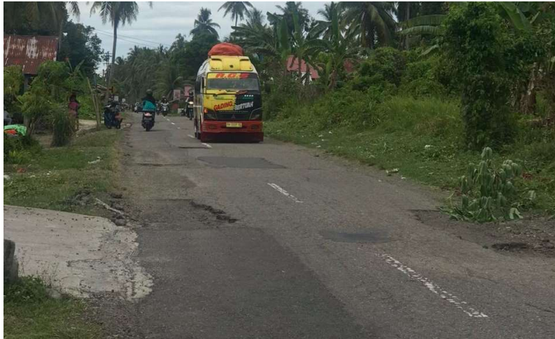
Gambar 1.2. Contoh Kerusakan Jalan Ruas Jalan Simp. Duku (Ketaping – Pariaman)
