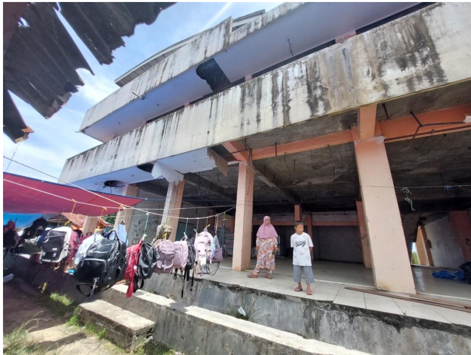
Gambar 2.6 Kondisi fisik bagian belakang bangunan kios pasar Inpres Tapus baru
