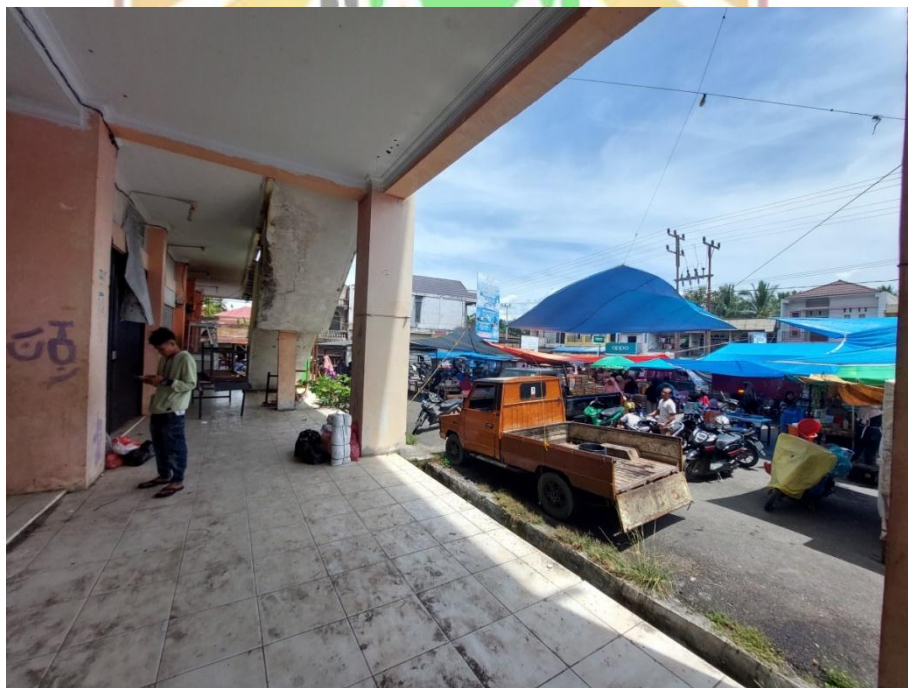
Gambar 2.7 Kondisi fisik bagian depan bangunan kios pasar Inpres Tapus baru
