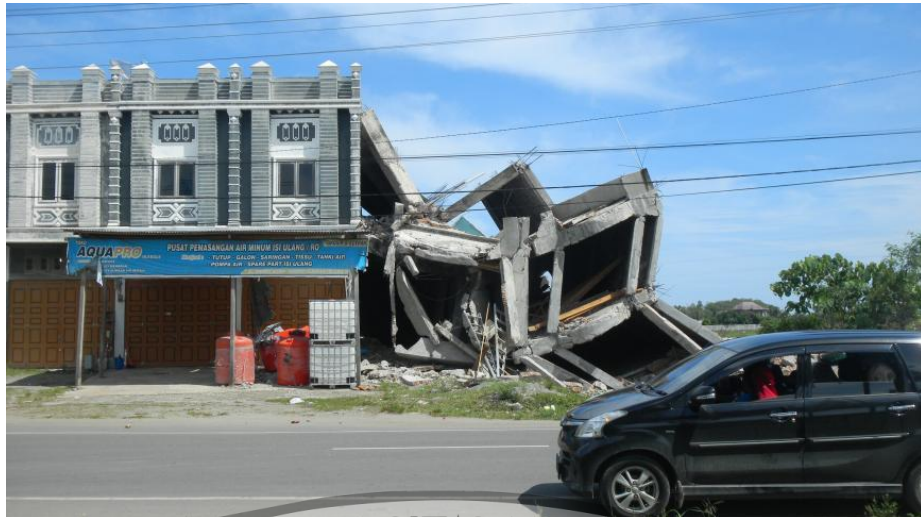
Gambar 1.2 Bangunan ruko rusak akibat gempa Aceh 2016
