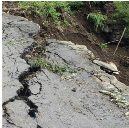
Gambar 1. 2 Keruntuhan Dinding Penahan Tanah di Dusun Brantas
