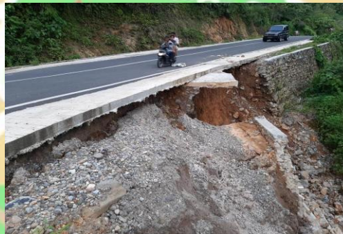
Gambar 1. 5 Dam penahan runtuh pada ruas jalan Teluk Bayur - Nipah – Purus KM 1+800
