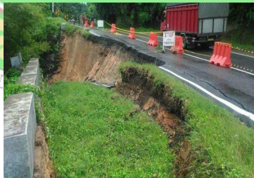
Gambar 1. 3 Dinding Penahan Tanah Runtuh Pada Jalan Utama Padang-Painan KM 42
