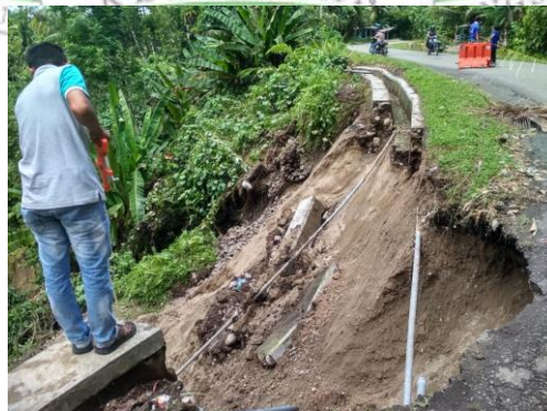
Gambar 1. 6 Dam penahan runtuh ruas Lubuk Basung - Sungai Limau KM 133 + 800
