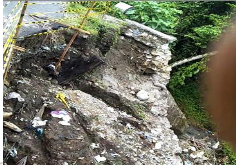
Gambar 1. 4 Dam Penahan Runtuh Pada Ruas Jalan Sumani- SP Ganting Payo KM 94+700
