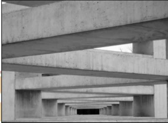
Gambar 1.1 Balok beton bertulang
