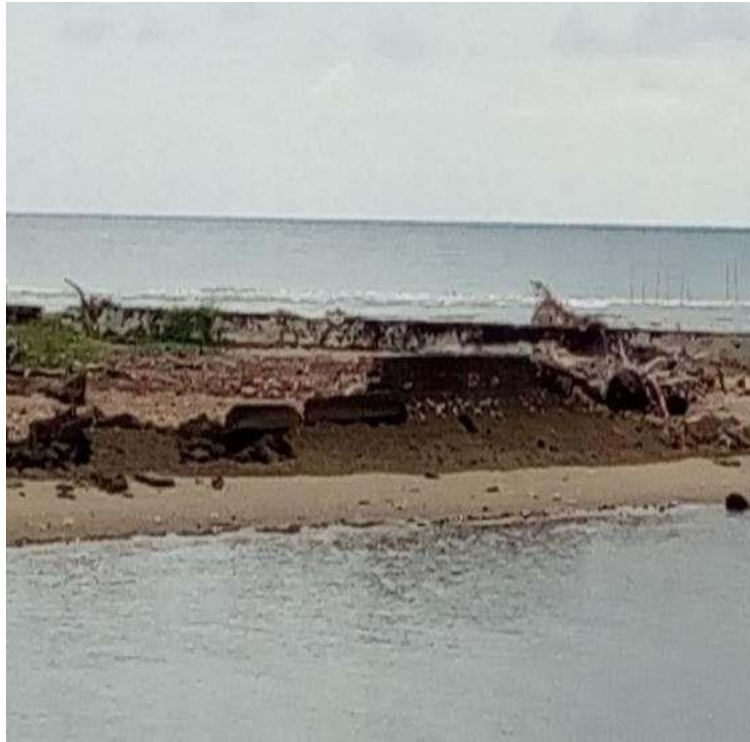
Kerusakan Bangunan Pelindung Akibat Abrasi yang Terjadi
