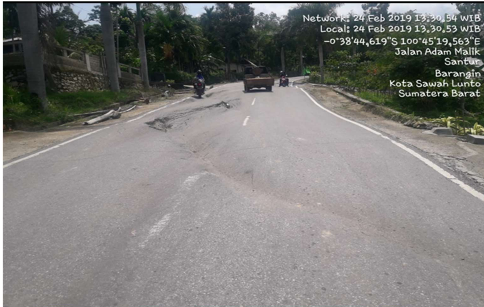
Gambar 1.1 Kerusakan Jalan pada STA 139+700 akibat tanah terban. (Sumber : Elan – Konsultan Perencana)
