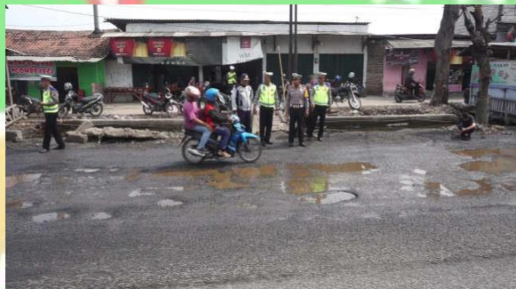
Gambar 1.4 Jalan Pantura Demak rusak berlubang (Wibowo, 2019)
