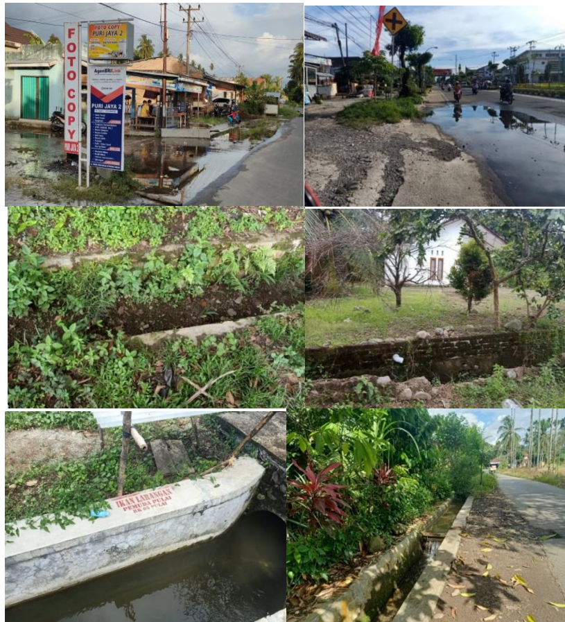
Gambar 1.3 Kondisi Drainase di Kecamatan Lubuk Basung
