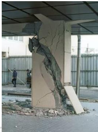
Gambar 1.3 Pola kerusakan geser pada kolom akibat overloading (PT. Hesa Laras Cemerlang, 2019)
