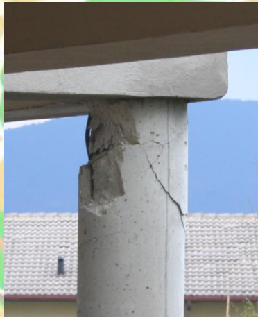
Gambar 1.2 Kegagalan geser pada kolom penampang melingkar (Ricci, Luca, & Verderame, 2011)
