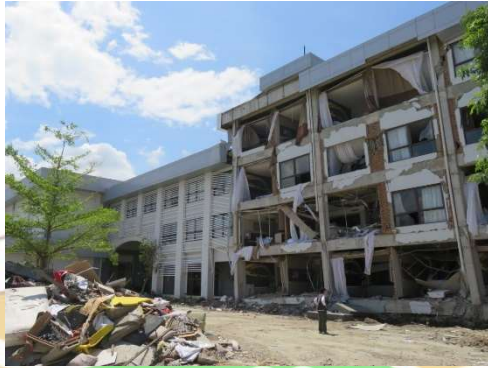
Gambar 1.1 Kerusakan pasca gempa bumi Palu
