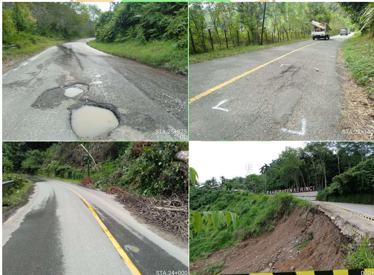
Gambar 1.2 Kondisi Jalan di Ruas Sei. Manau – Bts. Kerinci Sumber : Satker PJN2 Prov. Jambi, PPK 2.4 Ruas Sei. Manau – Bts. Kerinci, 2020
