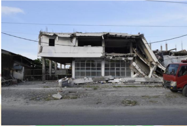
Gambar 1.4 Ruko Roboh Akibat Gempa Palu 2018
